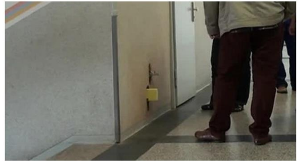
Der Trinkbrunnen wird einfach an das vorhandene Wassersystem angeschlossen.
